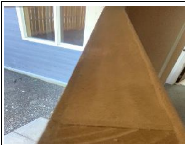
Foto N°13: 1 de julio de 2022 Ausencia de pintura en canto de puerta de acceso, de la vivienda ubicada en calle Roberto Gómez N°1420.
