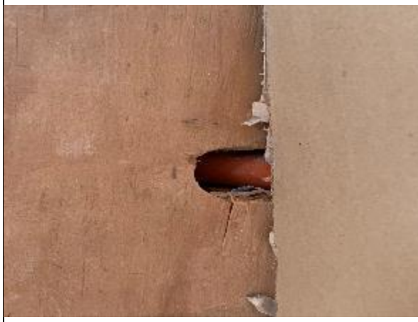
Foto N°11: 1 de julio de 2022 Placa de piso perforada para atravesio de ducto, en dormitorio 3, de la vivienda ubicada en calle Roberto Gómez N°1510.
