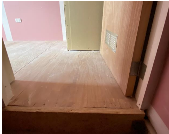
Foto N°9: 30 de junio 2022. Placa de piso dañada, en unión de escalera con dormitorio 3, de la vivienda ubicada en calle Cataluña N°210.
