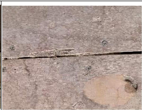
Foto N°8: 1 de julio de 2022 Placa de piso dañada, en dormitorio 2, de la vivienda ubicada en calle Roberto Gómez N°1510.
