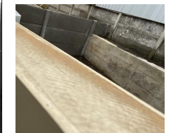
Foto N°16: 30 de junio de 2022. Ausencia de pintura en canto de puerta de cocina, de la vivienda ubicada en calle Cataluña N°210.
