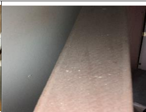
Foto N°14: 23 de junio de 2022 Ausencia de pintura en canto de puerta de baño, de la vivienda ubicada en calle San Diego N°1560.
