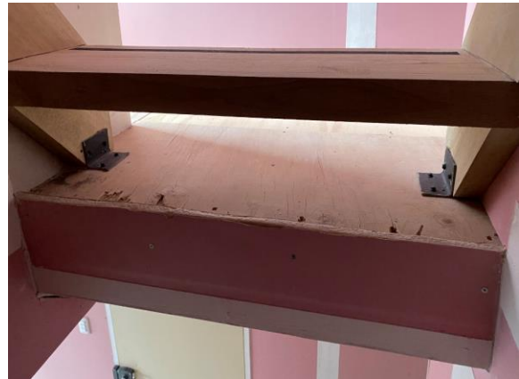
Foto N°10: 30 de junio 2022 Placa de piso dañada, en dormitorio 2, de la vivienda ubicada en Pasaje Bilbao N°45.
