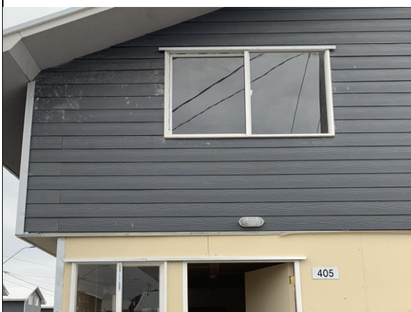
Foto N°17: 30 de junio de 2022 Mancha de pintura en siding de fibrocemento en el acceso de la vivienda de Cataluña N°405.
