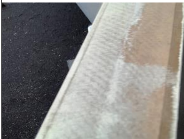
Foto N°15: 23 de junio de 2022 Ausencia de pintura en canto de puerta de cocina, de la vivienda ubicada en pasaje Bilbao N°125.
