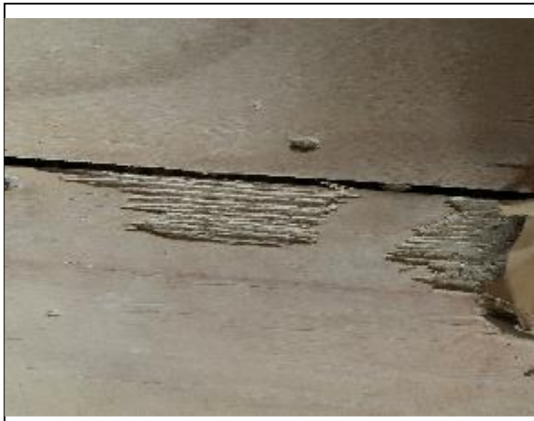
Foto N°7: 1 de julio de 2022 Placa de piso dañada, en sala de estar, de la vivienda ubicada en calle Fundador Osvaldo Jara N°530.
