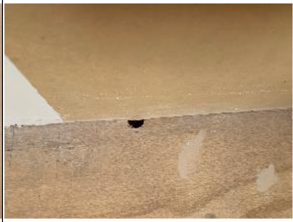
Foto N°12: 1 de julio de 2022 Placa de piso perforada para atravesio de ducto, en dormitorio 3, de la vivienda ubicada en calle Roberto Gómez N°1620.
