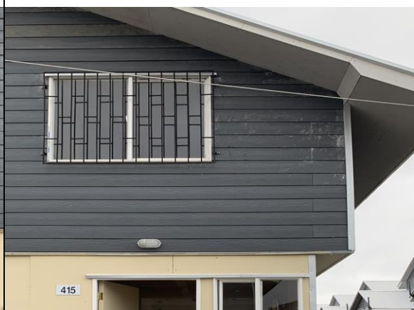
Foto N°18: 23 de junio de 2022 Mancha de pintura en siding de fibrocemento en el acceso de la vivienda de Cataluña N°415.
