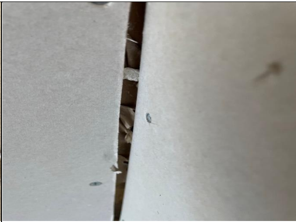
Foto N°20: 13 de diciembre de 2022 Separación excesiva placa de yeso cartón en muro de dormitorio 3, de vivienda ubicada en pasaje Citrino N°1392
