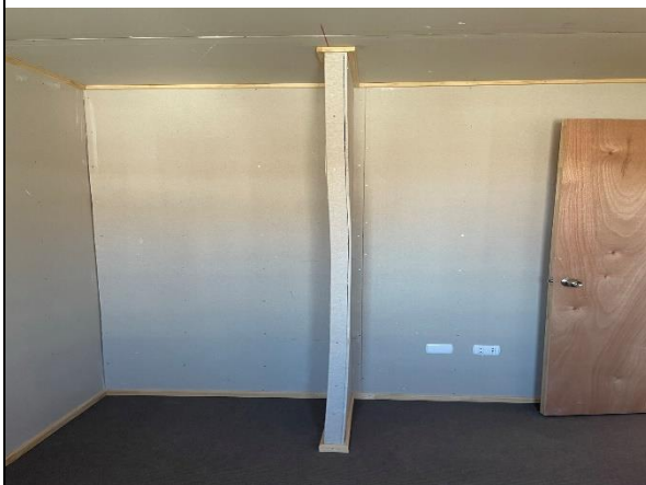
Foto N°23: 14 de diciembre de 2022 Desaplomo de tabiquería interior de muro, de vivienda ubicada en pasaje Granate N°1409.
