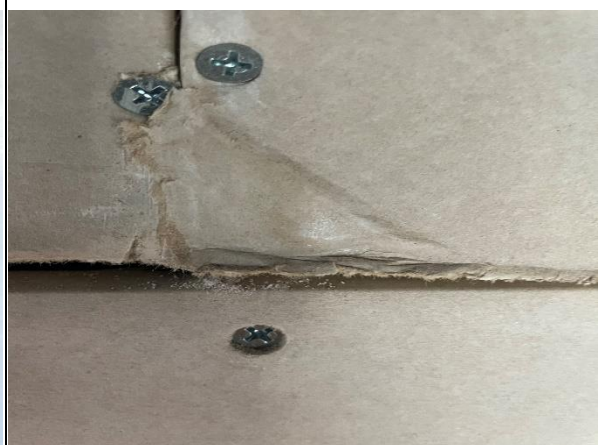
Foto N°18: 13 de diciembre de 2022 Placa de yeso cartón dañada en muro de escaleras, de vivienda ubicada en calle Piedra de Francia N°876.
