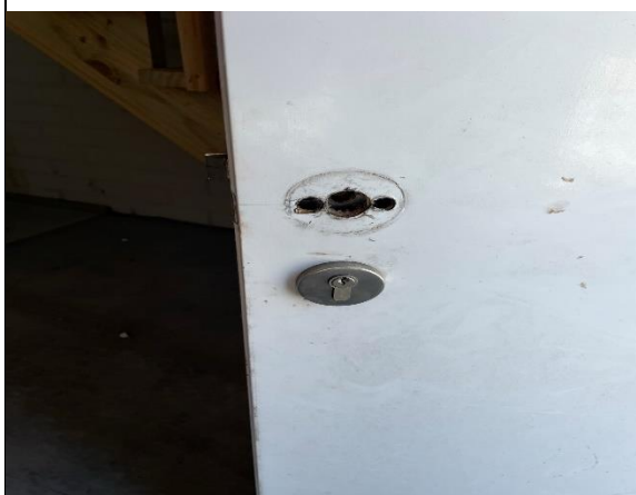
Foto N°17: 12 de diciembre de 2022 Quincallería dañada de puerta de acceso, de vivienda ubicada en calle Piedra del Sol N°732.
