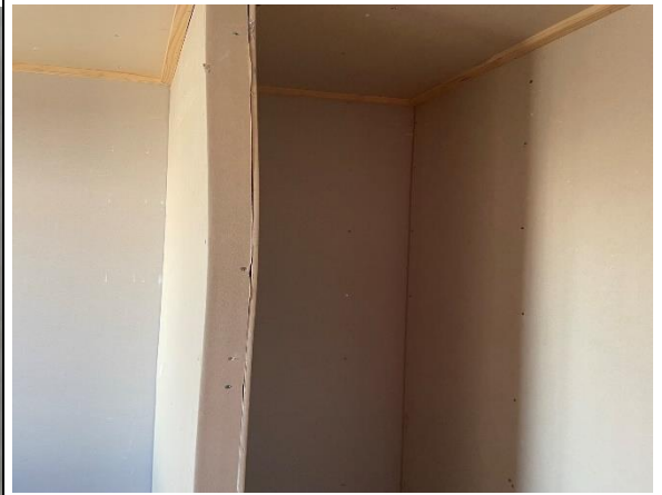
Foto N°22: 13 de diciembre de 2022 Desaplomo de tabiquería interior de muro, de vivienda ubicada en calle Piedra de Francia N°584.
