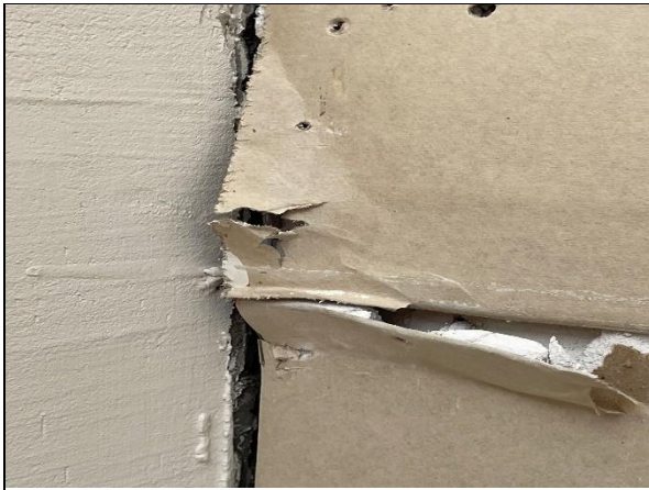
Foto N°19: 14 de diciembre de 2022 Placa de yeso cartón dañada en cielo de living, de vivienda ubicada en calle Uno N°1409.
