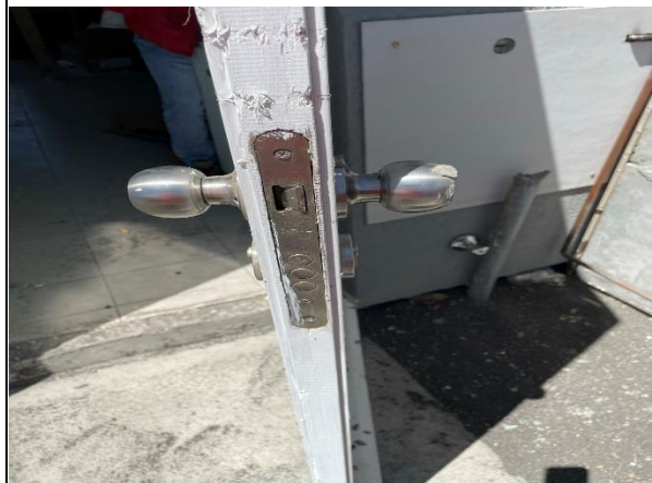
Foto N°16: 12 de diciembre de 2022 Quincallería dañada de puerta de cocina, de vivienda ubicada en calle Piedra del Sol N°852
