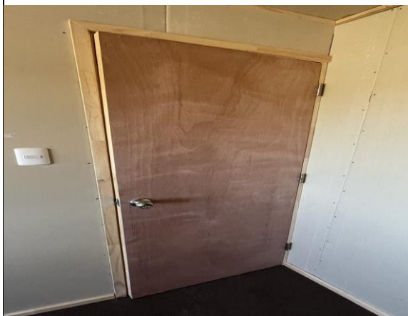
Foto N°15: 12 de diciembre de 2022 Puerta descuadrada en dormitorio 1, de vivienda ubicada en calle Piedra del Sol N°956.
