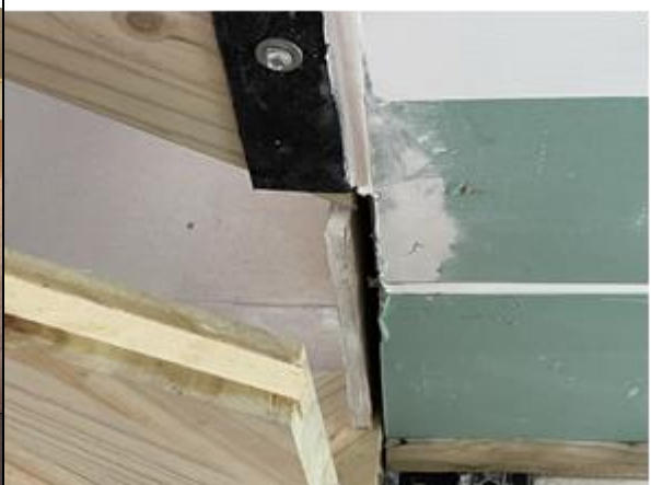
Foto N°24: 12 de diciembre de 2022 Encuentro de placa de cielo de cocina con muro de escalera, de vivienda ubicada en calle Piedra del Sol N°916.
