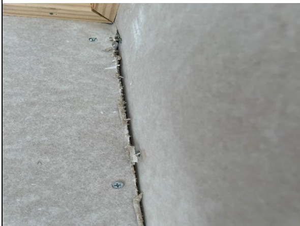
Foto N°21: 14 de diciembre de 2022 Placa de yeso cartón con cortes irregulares, en muro de dormitorio 1, de la vivienda ubicada en pasaje Granate N°1389.
