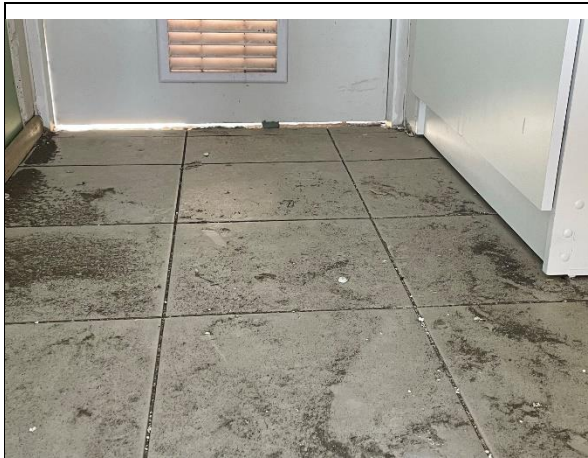
Foto N°13: 12 de diciembre de 2022 Separación entre puerta de cocina y piso, de vivienda ubicada en calle Piedra del Sol N°956.
