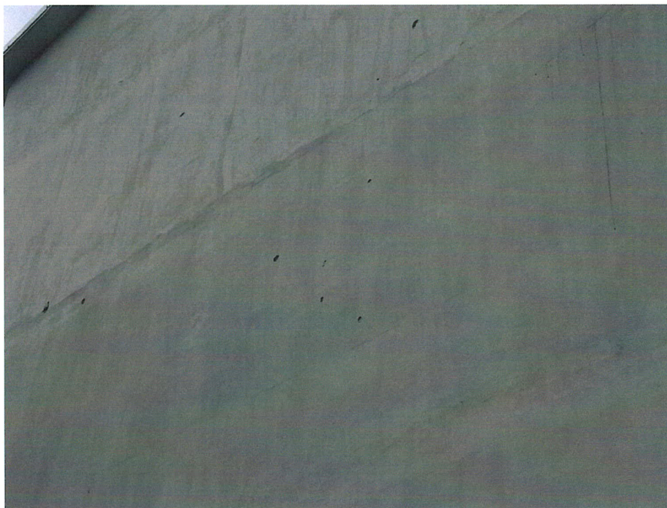
a) Daños en revestimiento exterior.
