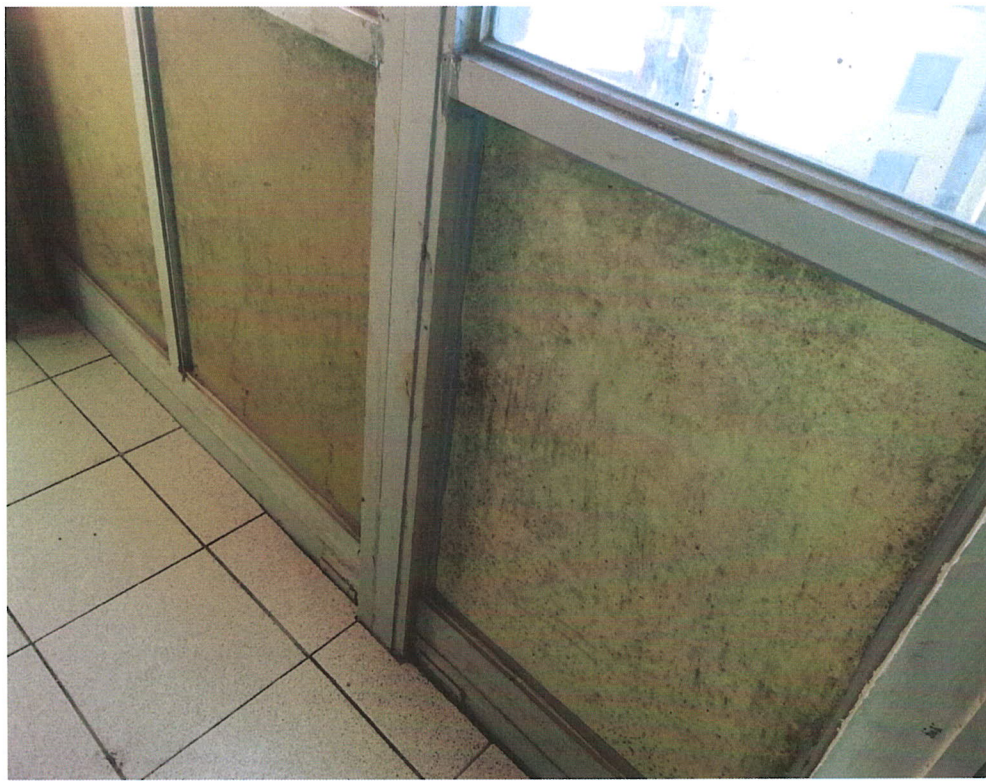
Filtración en ventana lado norte de caja escala, del block C.
