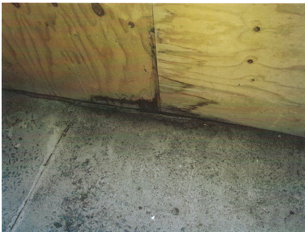
c) Filtración en pasillo, sector de encuentro de piso y muro.
