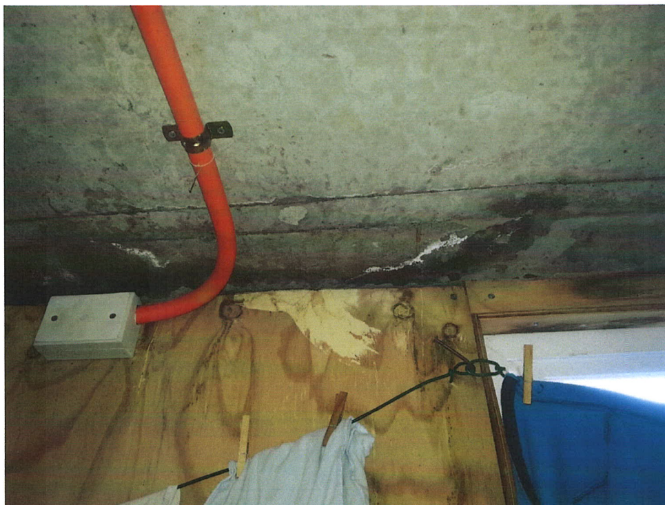
b) Filtración en pasillo, sector de encuentro de cielo y muro.
