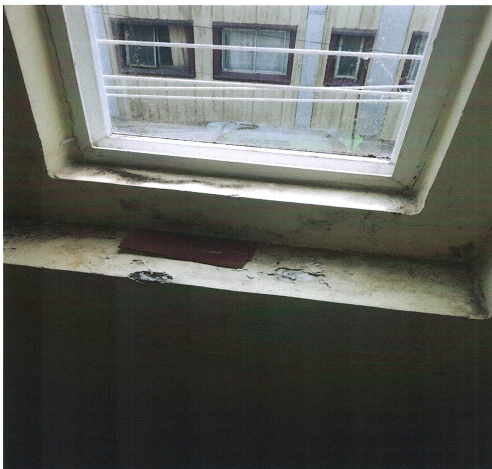
d) Filtración en ventana.
